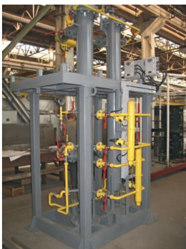
Блок фильтров подготовки газа
